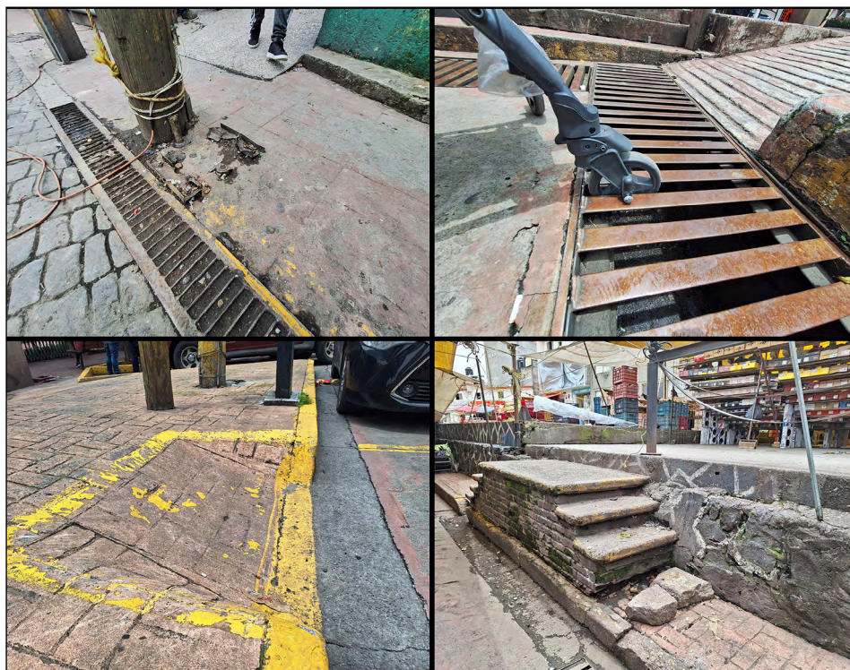
Imagen 6. Rejillas pluviales que se encuentran obstruidas por basura o lodo y otras barreras que afectan a todos los usuarios
